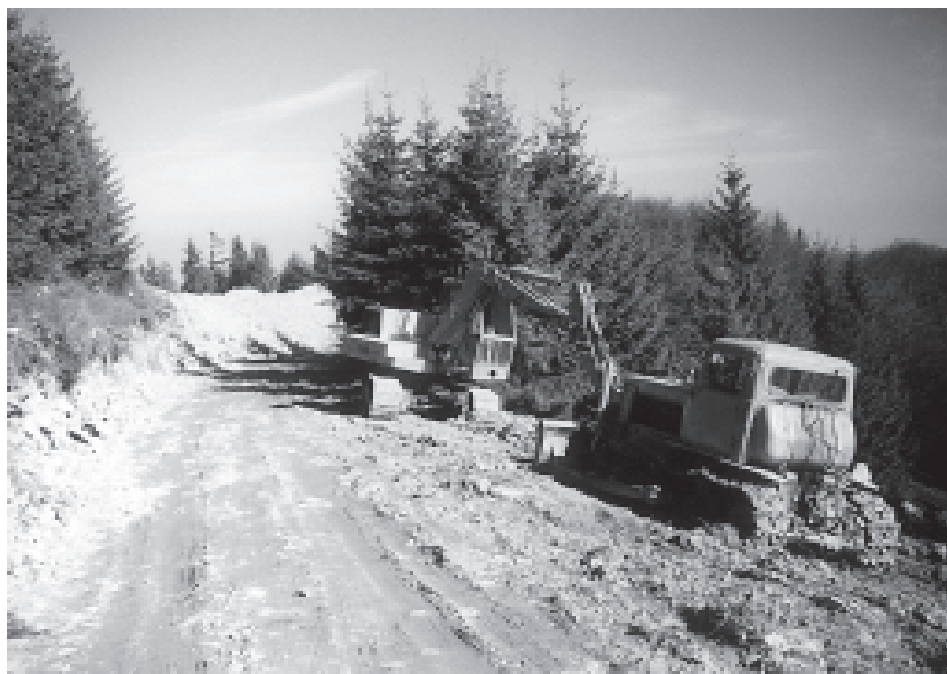
Ryc. 1. Erozja gleby i niszczenie lasu wzdłuż drogi dojazdowej w czasie budowy centrum narciarskiego (fot. M. Styczyński)
